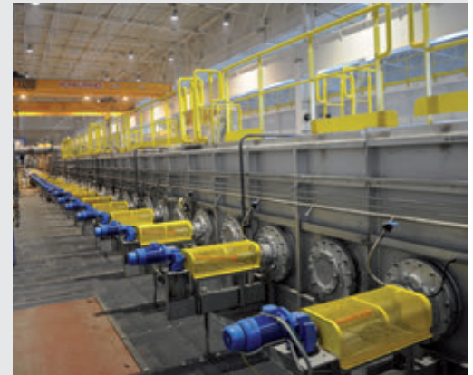
Vista del horno nuevo de St. Chély d’Apcher
