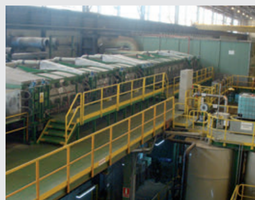
Les nouvelles installations de préphosphatation à Sagunto
