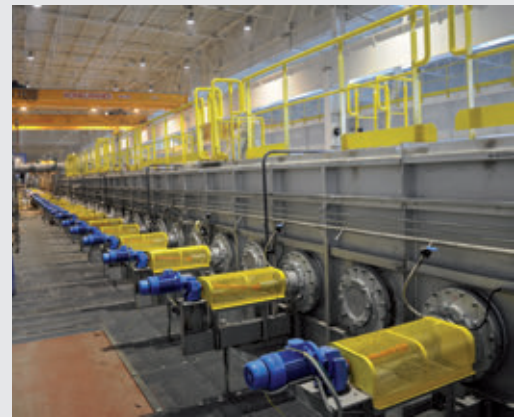
Zicht op de nieuwe oven in St. Chély d'Apcher
