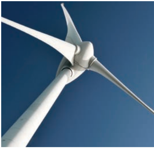
Windkraftanlage mit Stahlurm
