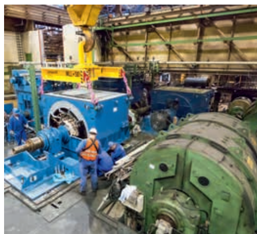
Montáž nového synchronního motoru tandemové studené válcovny pásu (vlevo) a starý stejnosměrný motor (vpravo)
