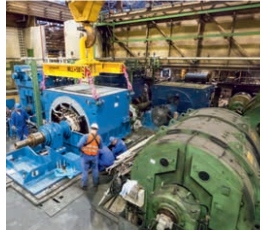
Montage des neuen Synchronmotors für das Tandem-Kaltwalzwerk (links) und ein alter Gleichstrommotor (rechts).
