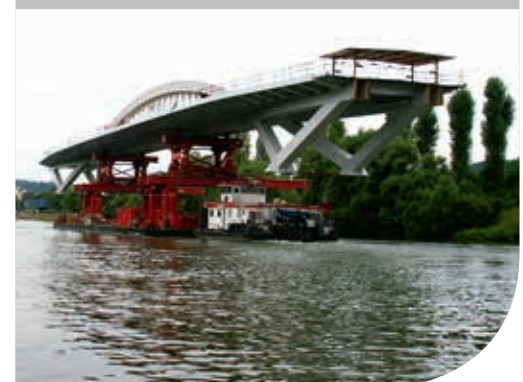
Transport de la travée centrale du pont par barge sur la Moselle.
