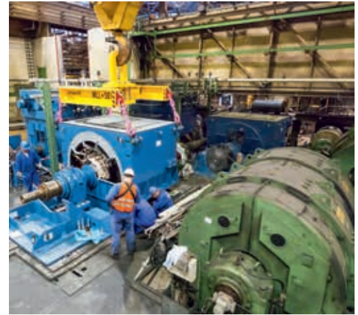
Installation du nouveau moteur synchrone sur le laminoir tandem (à gauche) et ancien moteur à courant continu (à droite).
